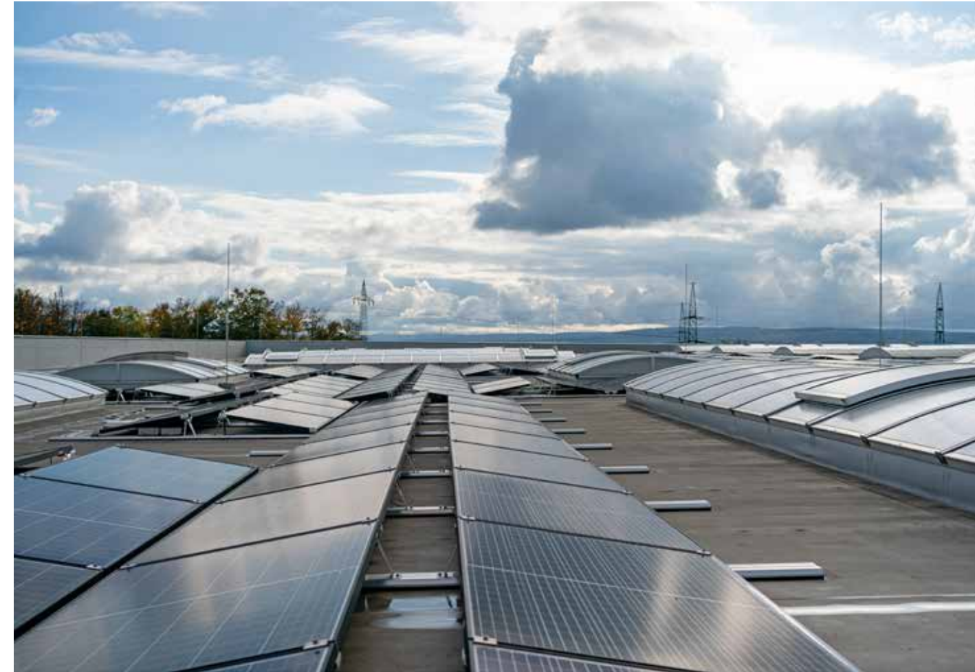
Photovoltaikanlage auf dem Dach des Neubaus der Lagerhalle am Standort Offheim
