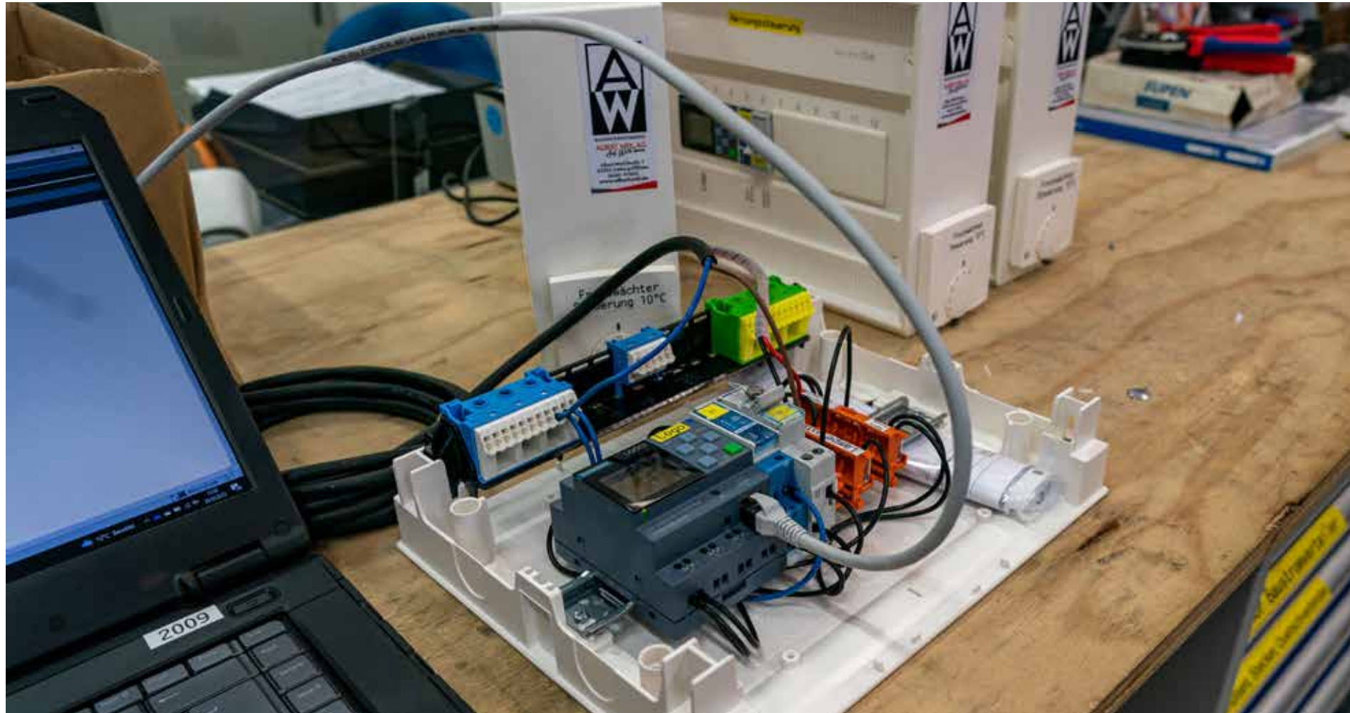
Albert Weil-Eigenbau: Heizungssteuerung und Zeitschaltuhr für die Baustellen-Container
